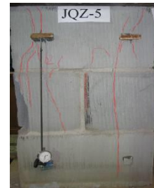
图 3.2 JQZ 组裂缝图
